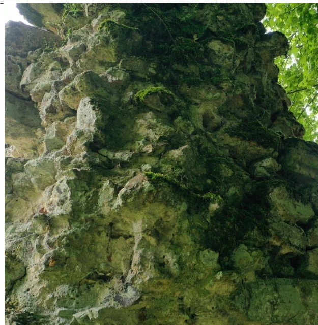
11. Mur séparatif Sud. Mur probablement chemisé présentant une grande lézarde indiquant le déversement en cours de la paroi. Infiltrations des eaux de pluies. Risque d'effondrement.
