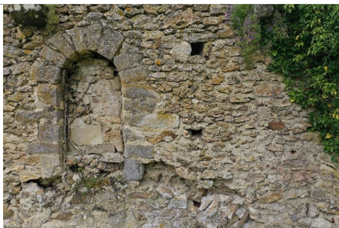
13. Baie bouchée de la chapelle Nord. Baie bouchée qui menait aux combles depuis le bras du transept. Traces de l'arrachement de la voûte en ogive.
