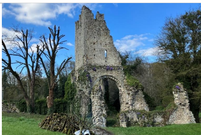
3. Clocher Sud. Moitié de façade effondrée au cours du dernier siècle. Arase en mauvais état. Maçonneries menacent de s'effondrer.
