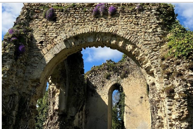
9. Arc Sud du clocher. Les claveaux en pierre de taille ont presque intégralement disparu. On ne retrouve que les moellons.
