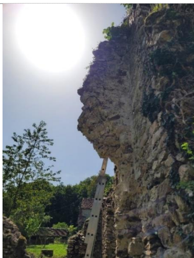
16. Départ d'arc dans la nef. Première travée supposée dans la nef.
