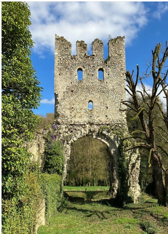
1. Clocher Ouest. Arases inégales. Les maçonneries ne sont pourvues d'aucune protection et sont directement exposées aux intempéries. Dégradation rapide.
