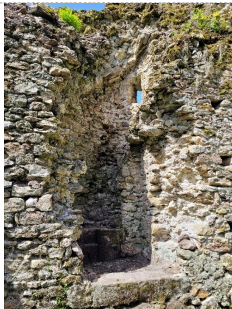
15. Escalier hélicoïdal de la nef. Escalier menant aux anciens combles. Majorité des marches disparues. Vestiges de la vis encore sur site.
