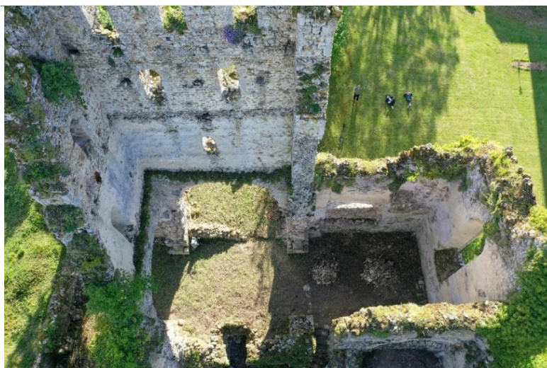
2. Vue aérienne du transept. Côté Sud manquant et côté nord partiellement effondré.
