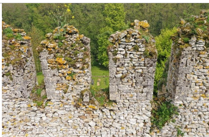
4. Baies Ouest du clocher. Les baies de la façade ont perdu leurs arcs, les appuis sont fortement dégradés. Les faces extérieures des trumeaux présentent un parement effondré. Déjointoiement généralisé des mortiers en façade.
