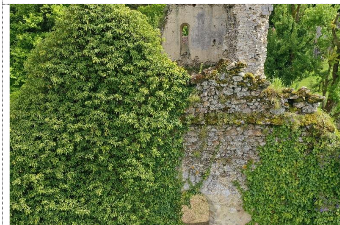
12. Bras Nord du transept. Façades recouvertes de végétation. Difficulté de lecture des pathologies des parements. Larmier détérioré et couvert de mousse.
