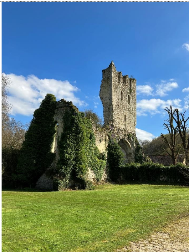
7. Vue Nord-Ouest. Les arcs des trois baies hautes se sont effondrés.
