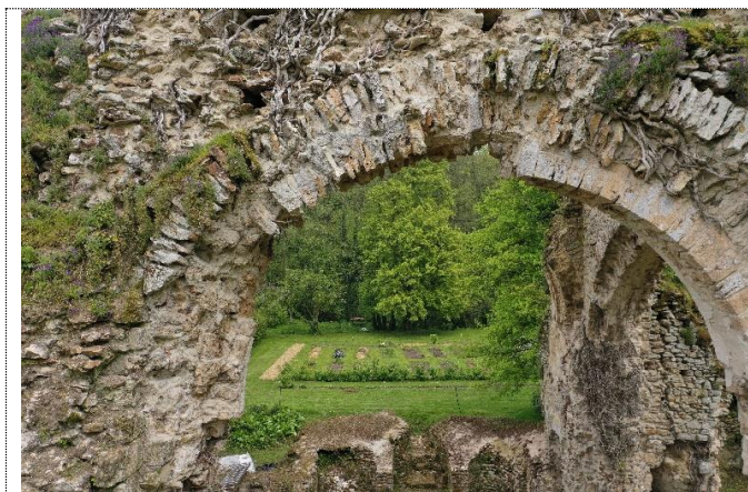
8. Arc Ouest du clocher. Un demi-arc en pierre de taille est encore en place. Son intégrité structurelle n'est plus conservée, menace d'effondrement.
