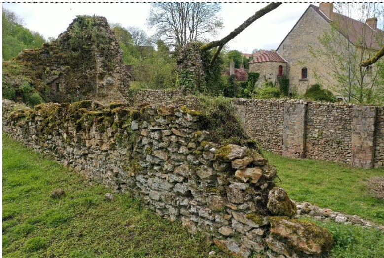
24. Élévation Sud du bas-côté. Présente un dévers dû à la poussée des terres. Déformation lente du mur et déjointement des maçonneries.
