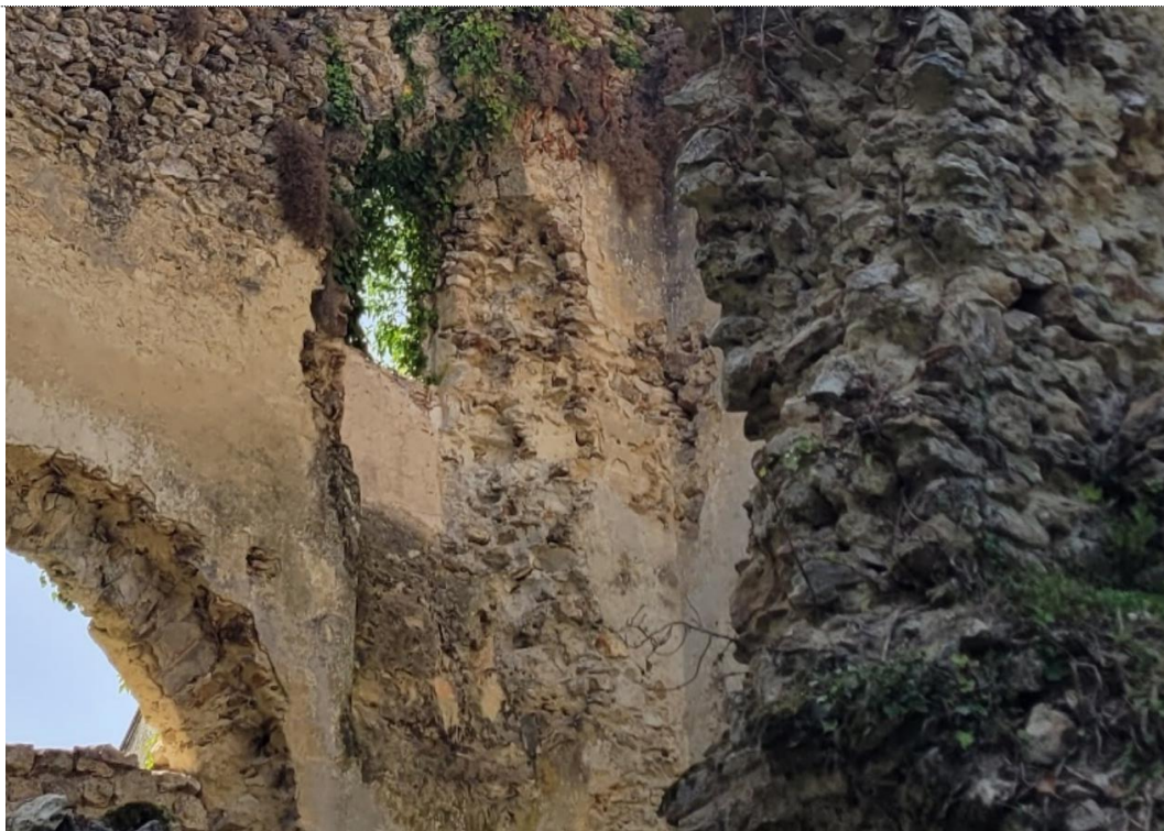
5. Fenêtre Nord. Glacis de la baie particulièrement altéré. Arrachement. Déjointement des maçonneries.
