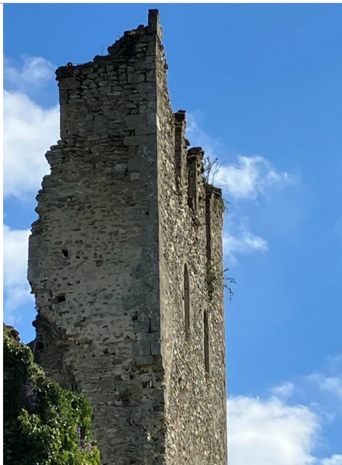
2. Clocher Nord. Arases en dévers prêtes à s'effondrer.
